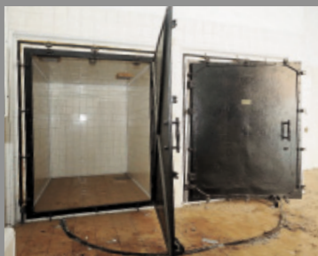
Compuertas de las cámaras de fumigación
